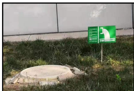
现有工程污水总排口
